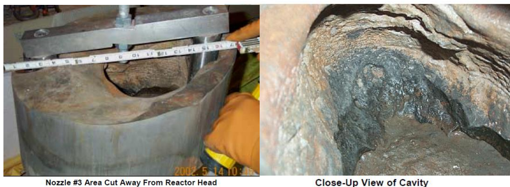
図 A-2.2 上蓋低合金鋼のほう酸腐食 (2), (3)
