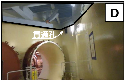
空調ダクトの貫通孔が天井付近に設置されていない小部屋（エアロック室）
